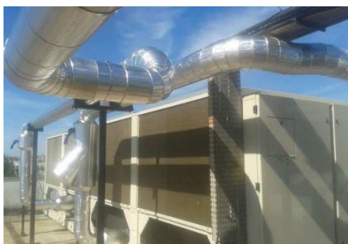
Chillers novos (Comarca de Macaé)
