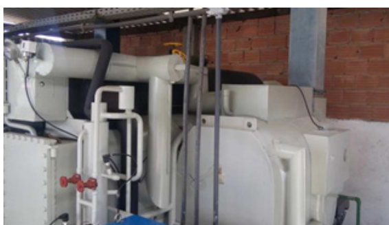
Chiller novo no local
