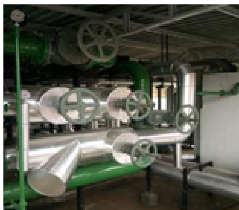
Instalação do Chiller
